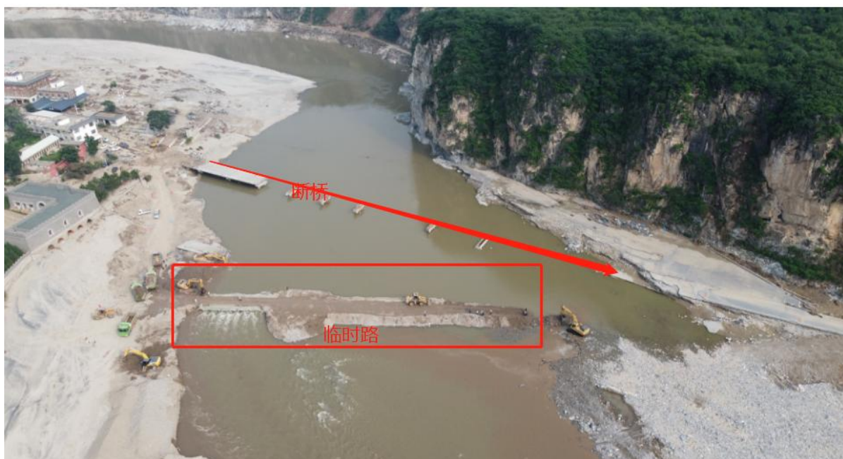
在涑水县三坡镇邢各庄村附近被冲毁的桥梁旁，天辰公司紧急施工作业。
